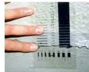
例: 亀裂損傷調査
