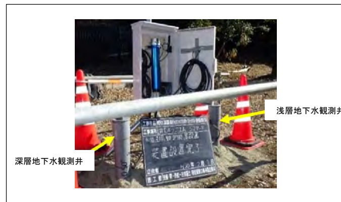
地下水位観測井(イメージ)
