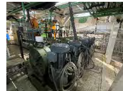
鉋物系添加材注入ポンプ
