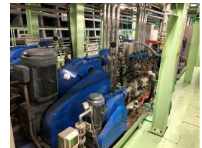
添加材注入ポンプ
