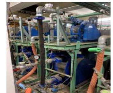
添加材注入ポンプ
