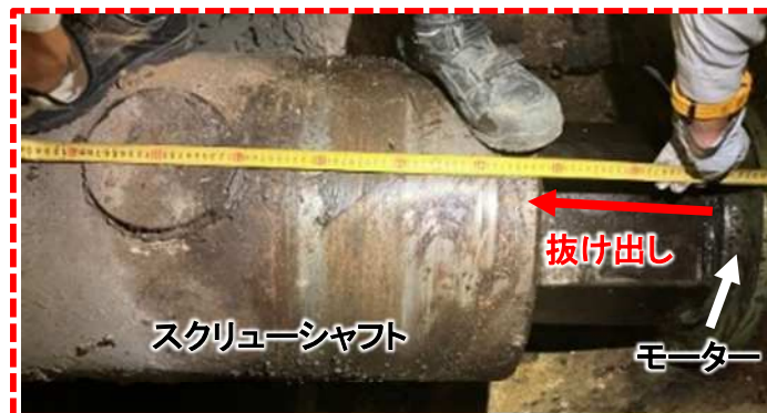
接合部の抜け出し状況
