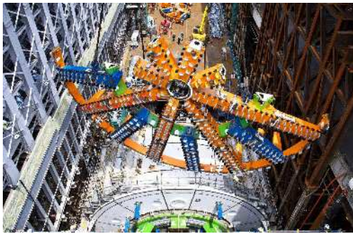
シールドマシンカッター部の投入・組立を行っている状況 (平成30年6月22日)
