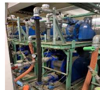
添加材注入ポンプ
