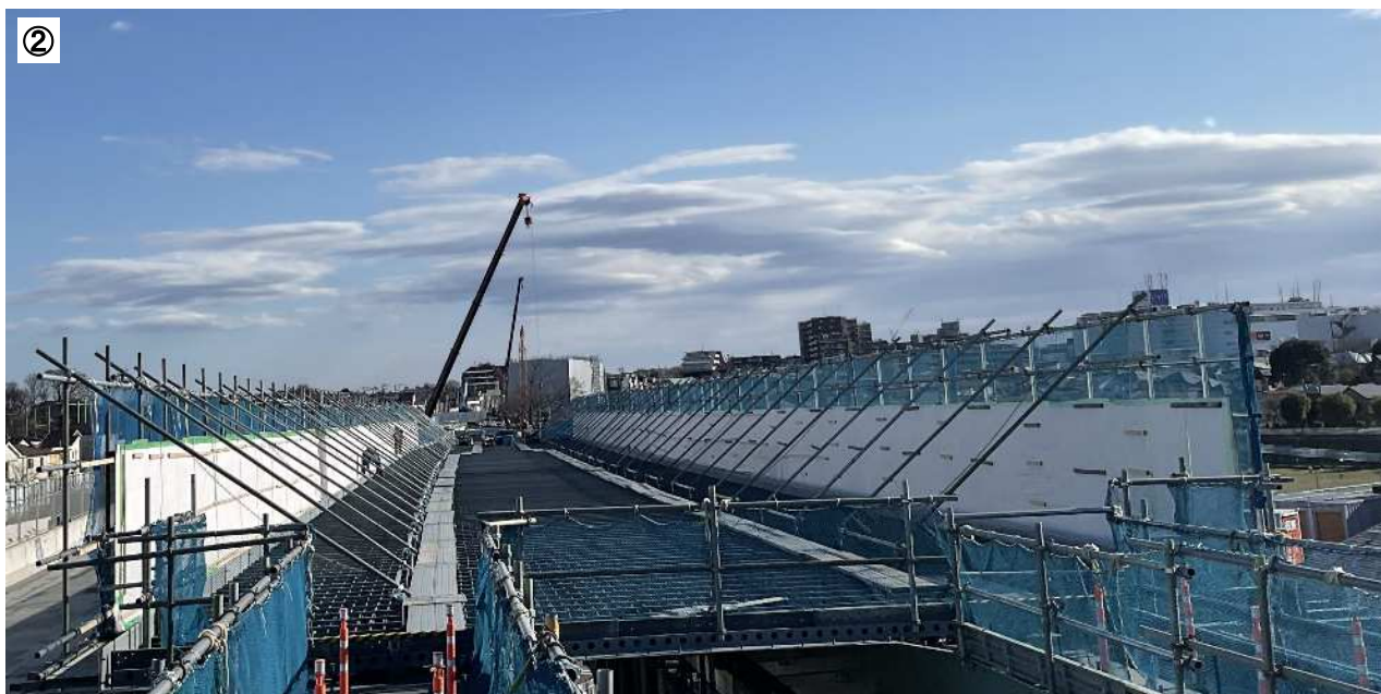
橋りょう上部の鉄筋コンクリート製床版の工事状況 (令和6年2月)
