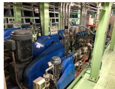
添加材注入ポンプ
