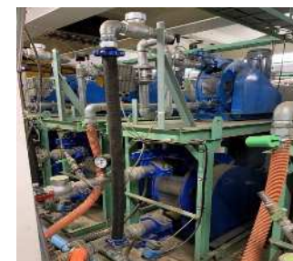
添加材注入ポンプ
