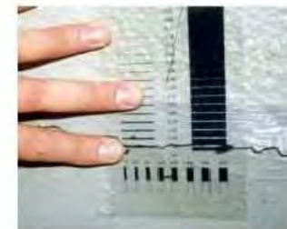
例: 亀裂損傷調査
