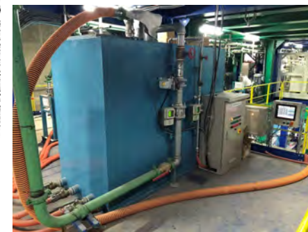
起泡溶液 作液タンク
