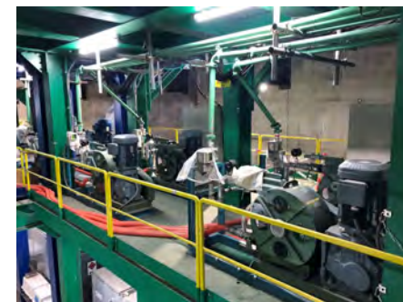
起泡溶液 注入ポンプ
