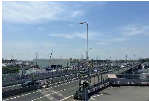
中央JCT上り線ONランプ工事用仮橋の状況 (令和5年5月18日)
