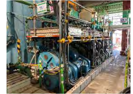
添加材注入ポンプ
