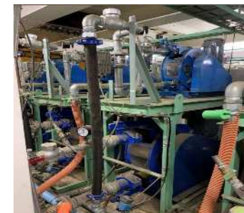
添加材注入ポンプ
