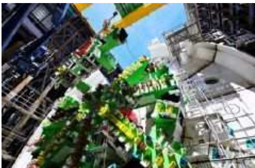
シールドマシンカッター部の投入・組立を行っている状況 (平成30年4月27日)
