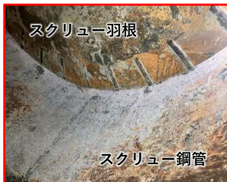
鋼管とスクリュー羽根の摩耗状況
