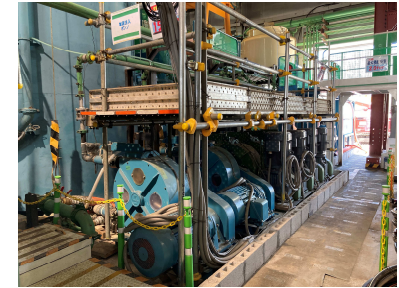
添加材注入ポンプ
