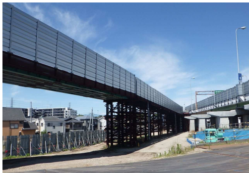
中央道へアクセスする工事用仮橋設置状況 (外景) (令和元年6月17日)
