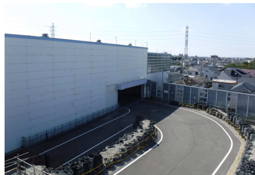
中央JCT南側ランプシールド防音設備設置状況 (令和4年9月27日)
