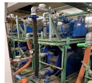
添加材注入ポンプ
