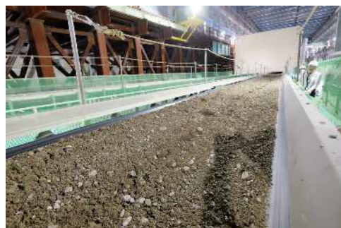
掘削した土砂をベルトコンベアで搬送する状況 (令和5年12月21日)
