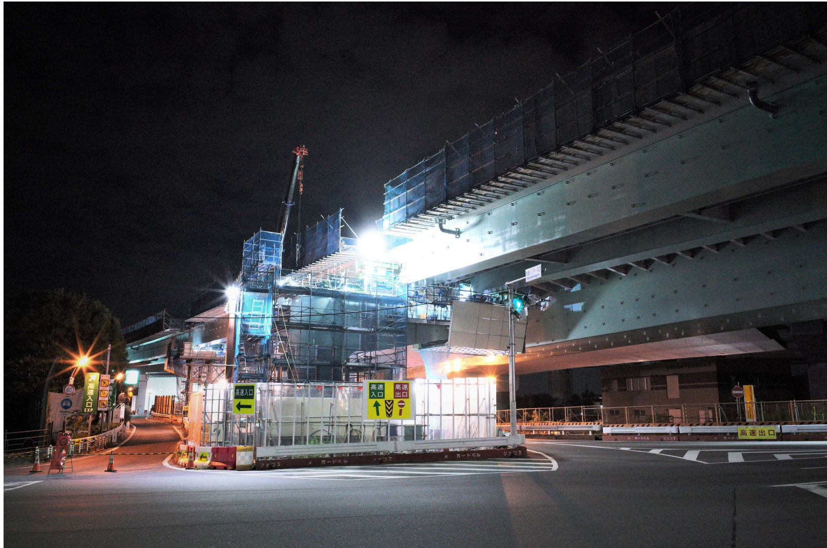
目白通り上空を交差する橋りょうの架設工事の様子 (10月26日)
